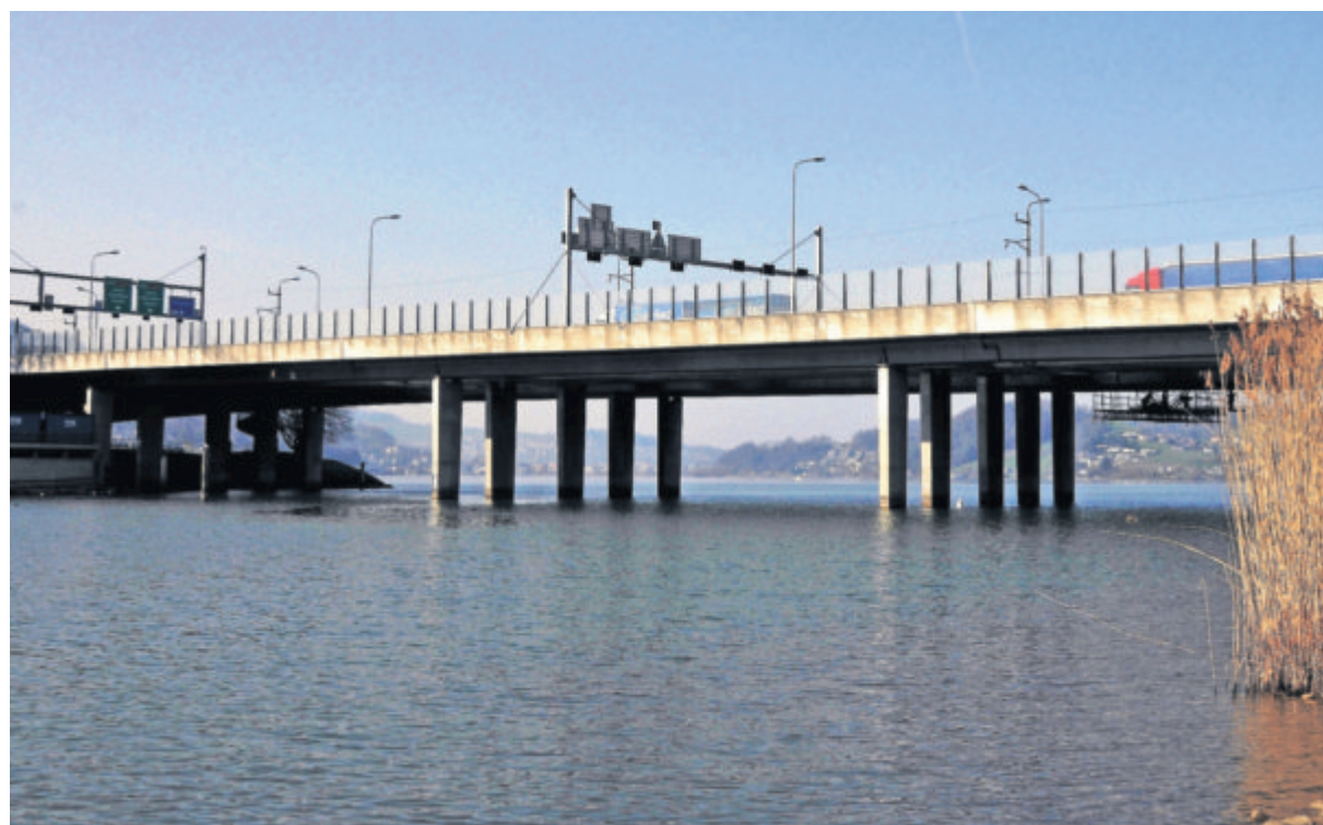
Die Achereggbrücke ist in einem schlechten baulichen Zustand und muss dringend saniert werden.
